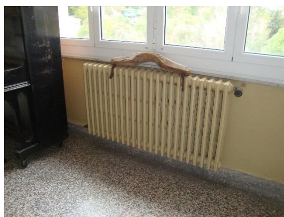
Figura 4.7 - Particolare radiatore installato nelle aule
