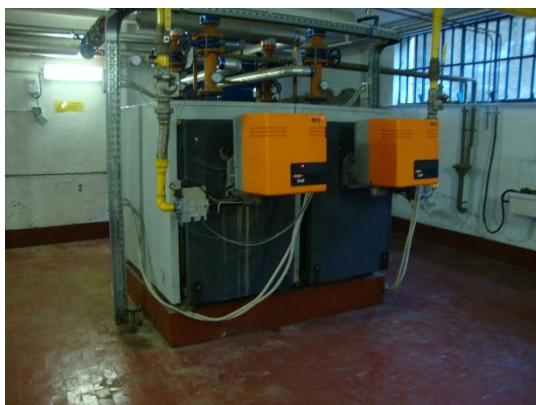
Figura 4.14 - Particolare di Caldaia a gas
