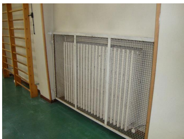
Figura 4.8 – Particolare radiatore installato in Palestra
