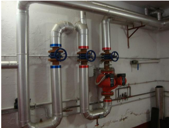
Figura 4.10 - Particolare della pompa di circolazione
