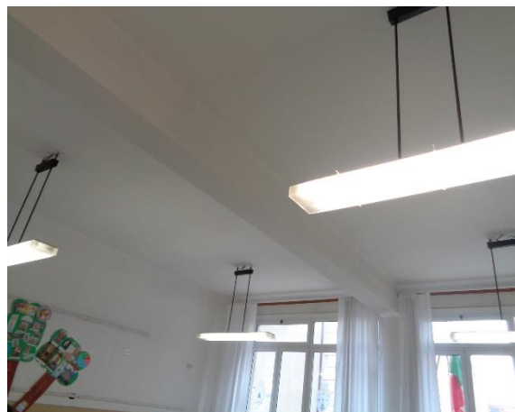
Figura 4.17 - Particolare dei corpi illuminanti ubicati nelle aule
